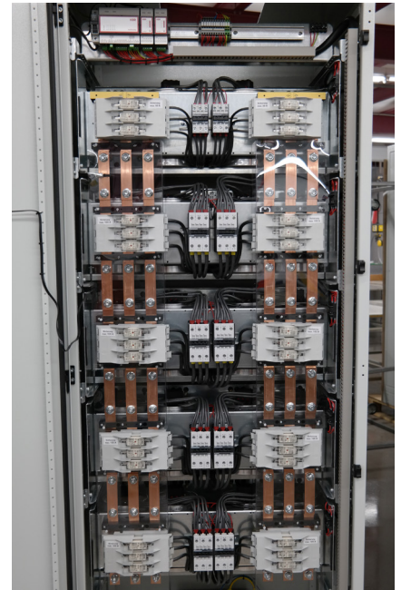
Abbildung 4: Eine Kompensationsanlage zu warten erfordert Fachwissen - unsere Techniker unterstützen Sie dabei gerne.
